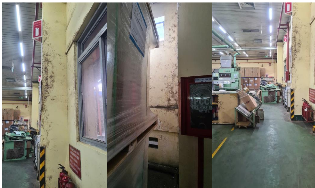
Hình 6: Mốc, thấm tại cột và tường PXVB.
