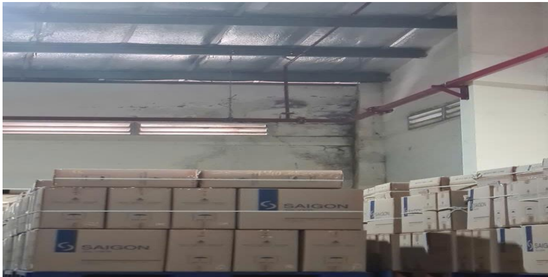
Hình 2: Tường bị ẩm mốc, bong tróc.
